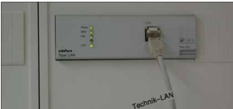
Der eibPort wurde in der Verteilung untergebracht.
