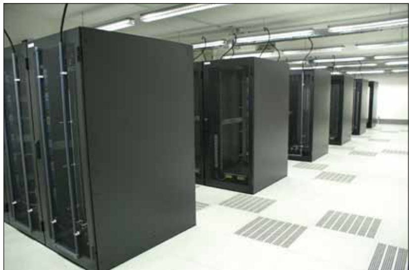
Ein frisch umgebauter Rechnerraum. Oben die Schläuche für die Absaugvorrichtung.
