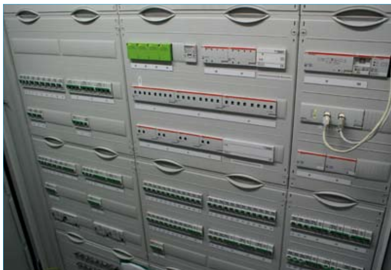
Unterverteilung: Hier befindet sich auch der eibPort, der gleichzeitig Interface und Visu- alisierungstool ist.
