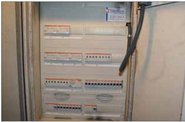
Im Gebäude gibt es insgesamt sechs Unterverteilungen. Diese befinden sich hinter dem Hauptaltar.
